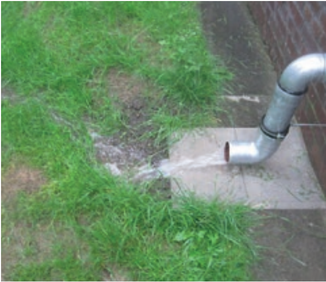
128 Sammlung von Dachflächenwasser
