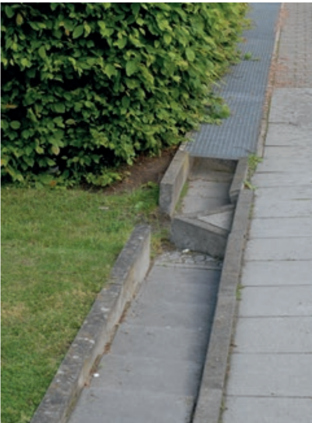
37 Ableitung von Regenwasser über eine teiloffene Kastenrinne in eine angrenzende Grünfläche
