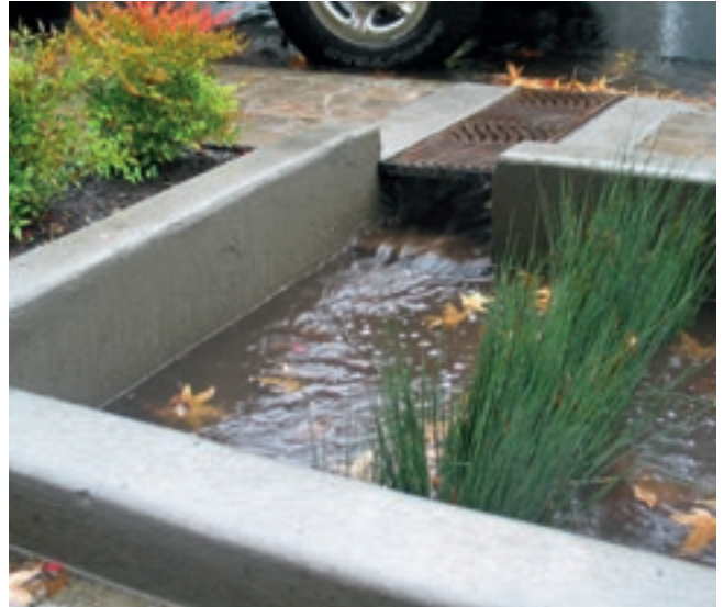
32 Zuleitung wenig belasteter Straßenabflüsse in ein Tiefbeet
